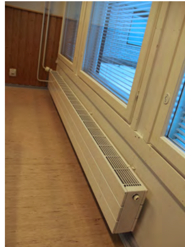
Uudet 1990-luvun radiaattorit on mitoitettu suurikokoisten ikkunoiden mukaan. Ikkunalaudat on poistettu lämmön siirtymisen vuoksi.
