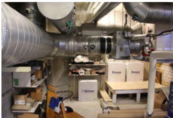
Lämpökeskus on täytynyt ilmanvaihtoputkista.
