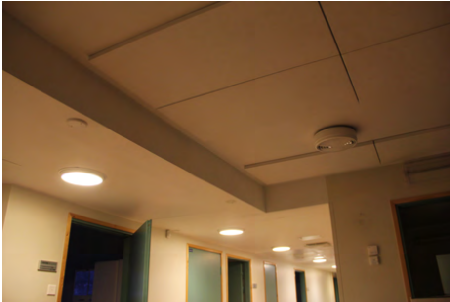
● Tekniikka on sijoitettu alaslaskettuun alakattoon.
