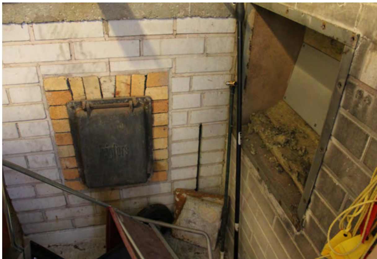
Öljykattilan lisäksi lämpökeskus on varustettu polttouunilla. Oikealla luukku kiinteän polttoaineen syöttämiseen.
