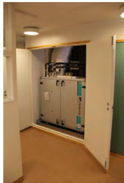
Uusi ilmanvaihdonkone. Sen takana on sähköpääkeskus.
