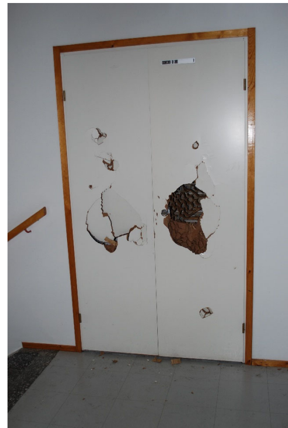
Yllä pari esimerkkiä sisätiloissa tapahtuneista tuhotöistä.
