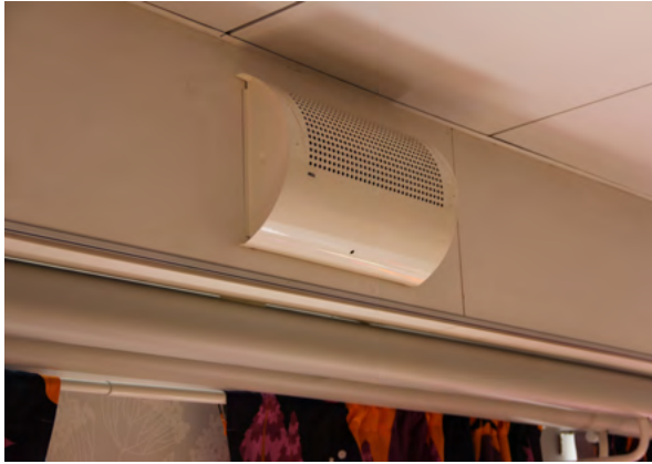
Ilmanvaihtokanavat ja -venttiilit ovat näkyvästi esillä päiväkodin tiloissa.
