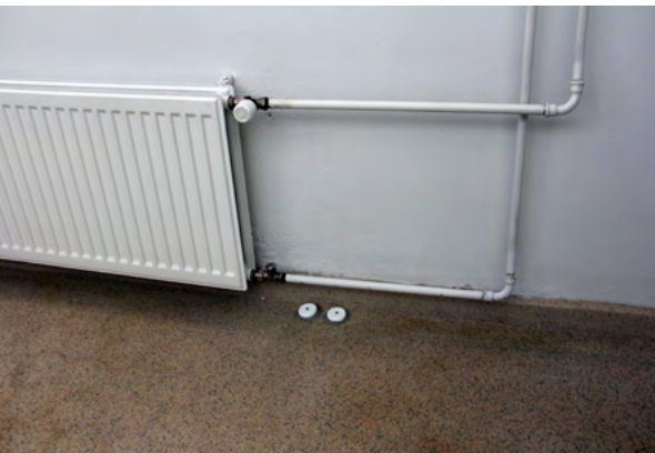
Alkuperäiset lattian alla kulkeneet putket on korkitettu.
