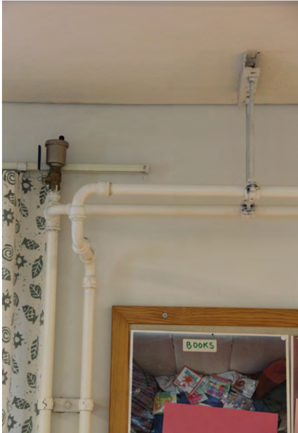
Uusitut lämpöputket kulkevat huonetilassa näkyvillä tai koteloituna.
