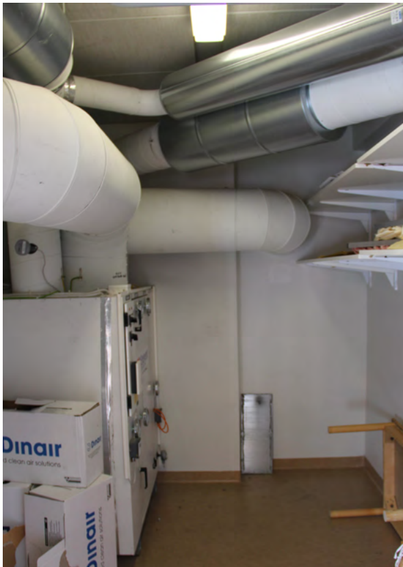
Rakennuksessa toimii hajautetusti yhdeksän ilmanvaihtokonetta.
