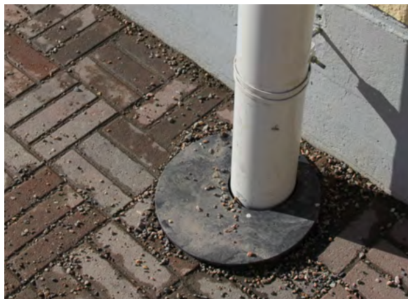
Sadevesi johdetaan syöksyistä suoraan kokoojakaivoon.
