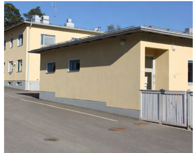
Hulevesikaivo ja salaojan tarkastuskaivot etupihan asfaltissa.
