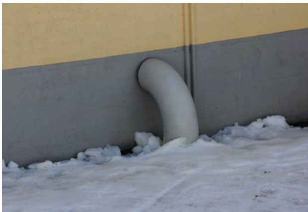
Kellarin tuuletusputki nousee sokkeliä vasten.
