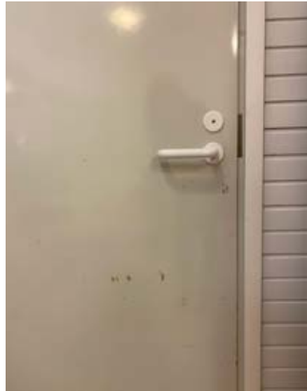
2. Väliovissa maalipinta on paikoitellen kulunut. Kuva: Hilda Peltokorpi 2024
