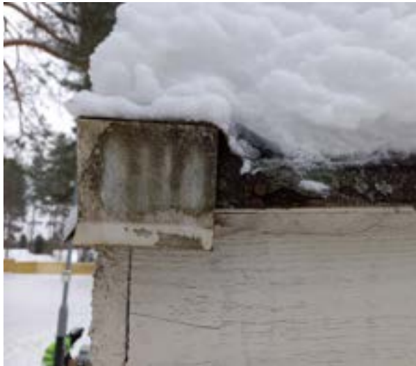
Pihan eteläpuoleinen varaston kattohuopa ja pellitys vaikuttivat huonokuntoisilta. Lisäksi ovesa havaittiin kulumista. Toisaalta varaston runkorakenteet olivat ehjät. Kuva: Kirsikka Lehtiniemi 2024
