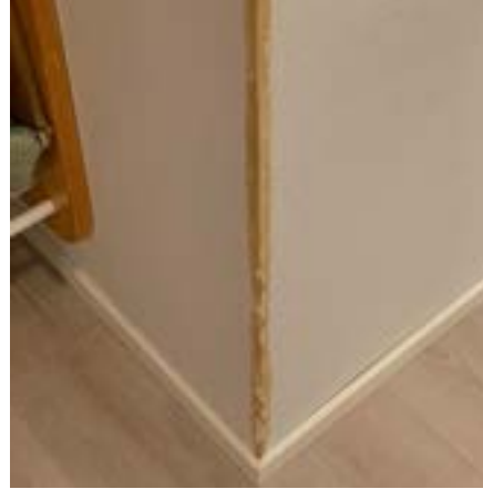
Vaurio 46. Liimajälkiä seinän nurkassa. Huone 24. Kuva: Salli Nokelainen 2024.
