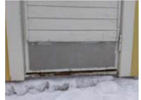
Pohjoisen varaston oven kynnyks on vaurioitunut. Kuva: Kirsikka Lehtiniemi 2024
