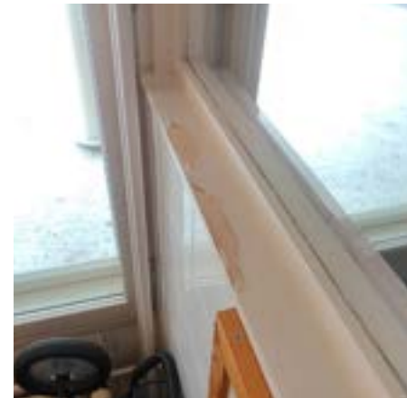
Vaurio 97. Maalipinnat hilseilleet ikkunalaudoissa. Huone 50. Kuva: Roope Mustonen 2024.
