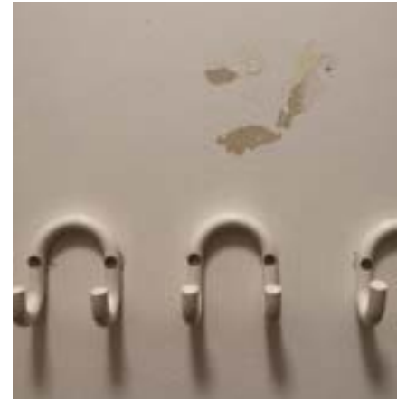
Vaurio 56. Maalit hilseilleet ja lohkeilleet seinissä. Huone 23. Kuva: Lauri Antila 2024.
