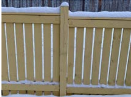
Korotettu aita. Aidat on korotettu pilareita uusilla palasilla korottamalla. Pilareissa on jonkin verran kulumaa. Kuva: Riku Repo 2024
