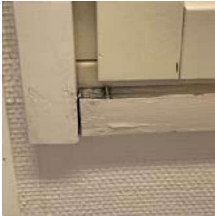
Vaurio 44. Ikkunankarmi haljennut. Huone 19. Kuva: Salli Nokelainen 2024.
