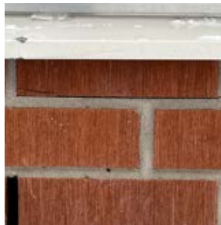
Tiilessä halkeama. Katja Maaninka 2024.
