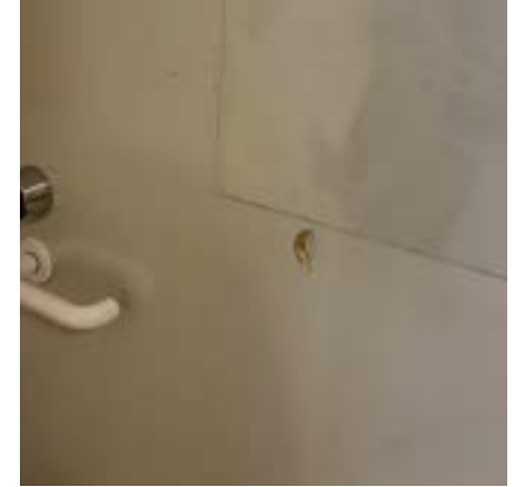
Vaurio 34. Kolhu ovesta. Huone 17. Kuva: Salli Nokelainen 2024.
