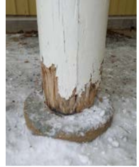
4. Sisääntulokatoksessa on yksi pahemmin vaurioitunut pílari. Kuva: Kirsikka Lehtiniemi 2024
