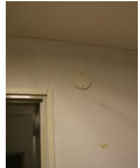
8. Katon ja seinän sauma on paikoitellen halkeillut. Kuva: Kim Ramsay 2024.
