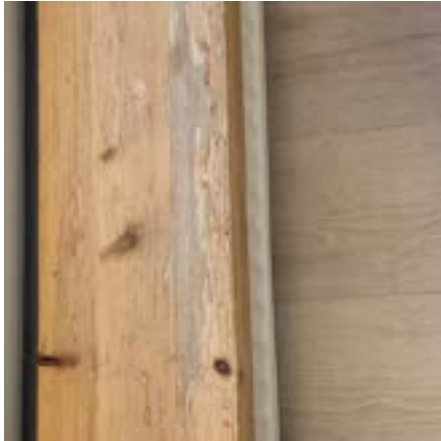
Vaurio 50. Ikkunalaudan puupinta kulunut. Huone 22. Kuva: Salli Nokelainen 2024.
