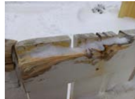
Koululaisten portin lukitussalvan aiheuttamia vaurioita. Puu on kulunut melko paljon. Kuva: Kirsikka Lehtiniemi 2024
