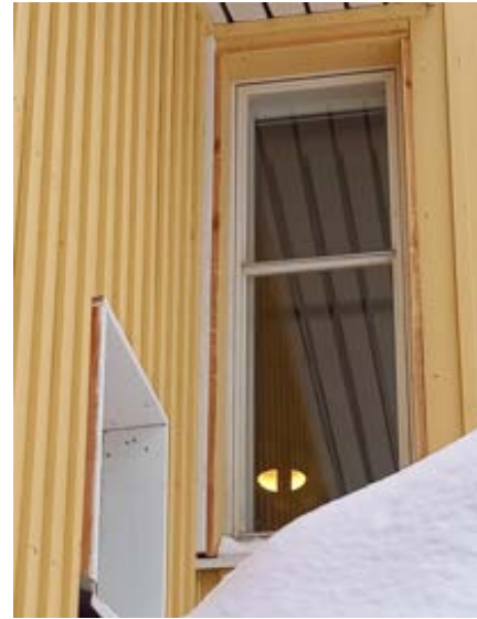
3. Rakennuksen torniosasan kahdessa ikkunasta puuttuvat vuorilaudat. Kuva: Kirsikka Lehtiniemi 2024
