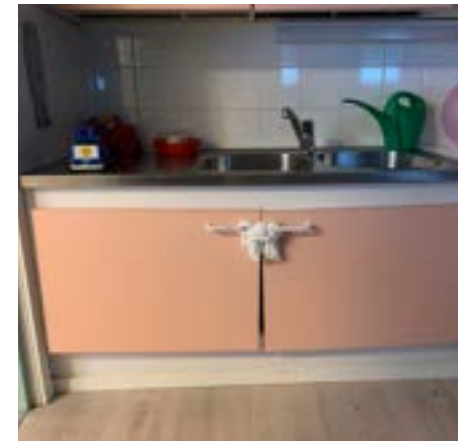
Vaurio 57. Kiintokalusteiden ovien saranat ovat sijoiltaan. Huone 26. Kuva: Salli Nokelainen 2024.
