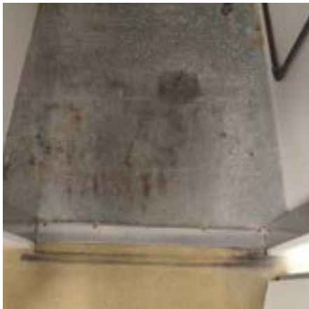
Vaurio 78. Lattiassa kosteuden aiheuttamia ruostevaurioita. Huone 37. Kuva: Roope Mustonen 2024.
