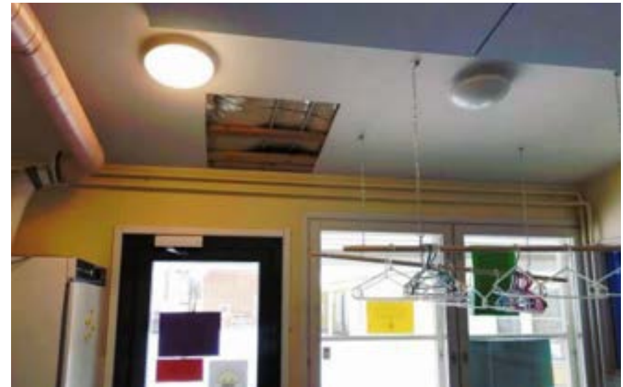
Keltaiset seinät ja vaaleanpunainen IV-putki kuravaunueteisessä 50 vuonna 2022. Kummatkin on maalattu myöhemmin valkoiseksi, samoin muissa kuraeteisissä. Kuva: Kosteus- ja sisäilmatekninen kuntotutkimus 2022.
