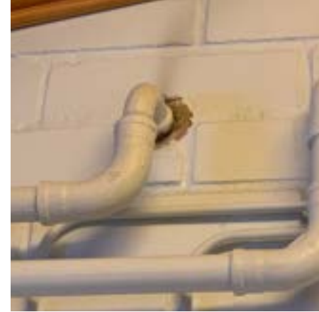
Vaurio 76. Liitoskohdassa peittämätön poraus jälki. Huone 30. Kuva: Salli Nokelainen 2024.
