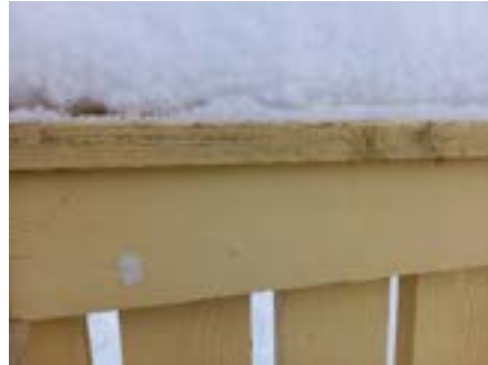
Aitojen päälyslautojen tyypillisiä maalivaurioita. Rakennuksen pohjoispuolella aidoissa on enemmän tummenemaa. Kuva: Kirsikka Lehtiniemi 2024
