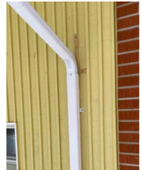
8. Seinään on jäänyt jälkiä vanhoista syöksytorstista. Kuva: Riku Repo 2024
