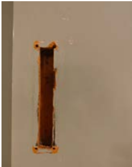
5. Monitoimitilan ovessa oleva jälki poistetusta oven kahvasta. Kuva: Hilla Niemelä 2024.
