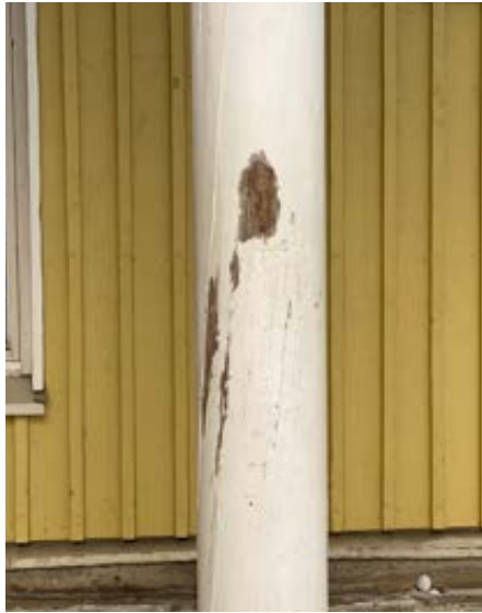
1. Pilarien tyypillisiä pintavaurioita. Kuva: Riku Repo 2024
