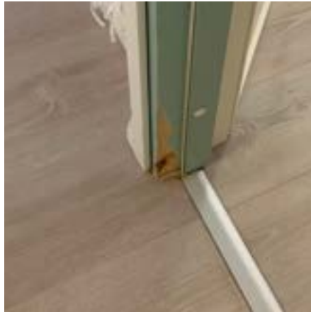
Vaurio 73. Kolhuja ovenkarmeissa. Huone 31. Kuva: Salli Nokelainen 2024.
