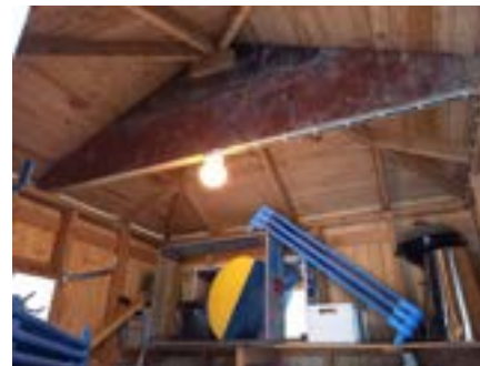
Kuvassa pohjoinen varasto. Sisältä varasto vaikuttaisi olevan kohtalaisessa kunnossa. Kuva: Kirsikka Lehtiniemi 2024
