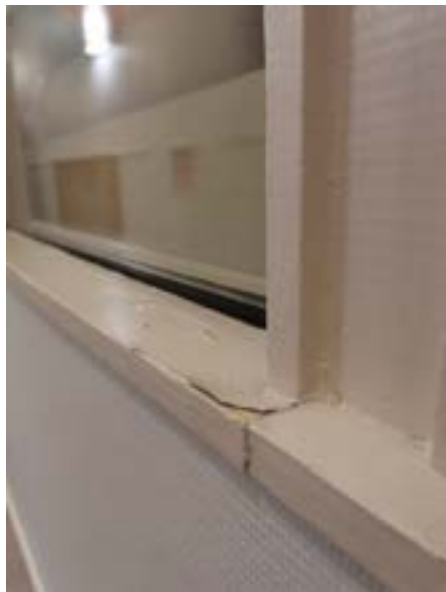
Tyyppillinen pintavaurio sisäikkunassa. Kuva: Lauri Antila.
