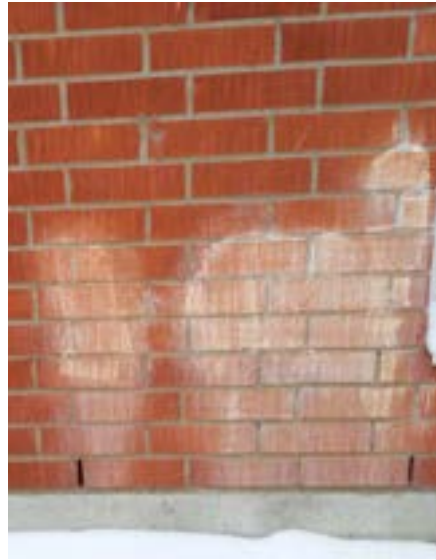
2. Tiiliseinässä on isohko jälki maalitöhrystä. Kuva: Kirsikka Lehtiniemi 2024
