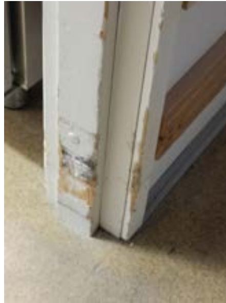
Vaurioita keittiön oven karmissa. Kuva: Vilja Kinnunen.
