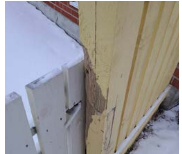
Piha-aidassa ja -porteissa on yleistä kulumista maalipinnassa. Osassa pihaporteissa oli havaittavissa runsaasti käytöstä aiheutunutta kulumista. Piha-aitaan on tehty vuonna 2020 korotus ja huoltomaalaus. Sitä aikaisempi huoltomaalaus aitaan tehtiin noin 10 vuotta sitten. Piha-aidan korostusjäljet havaittavissa runkotolpissa. Kuva: Vilja Kinnunen 2024
