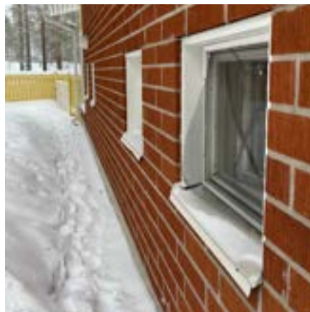
Vaurio 6. Ikkunoiden hyttysverkot rikkinäisiä. Roope Mustonen 2024.
