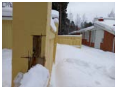
Pääportin pilarin huolimattonta detaljointia. Kuva: Kirsikka Lehtiniemi 2024
