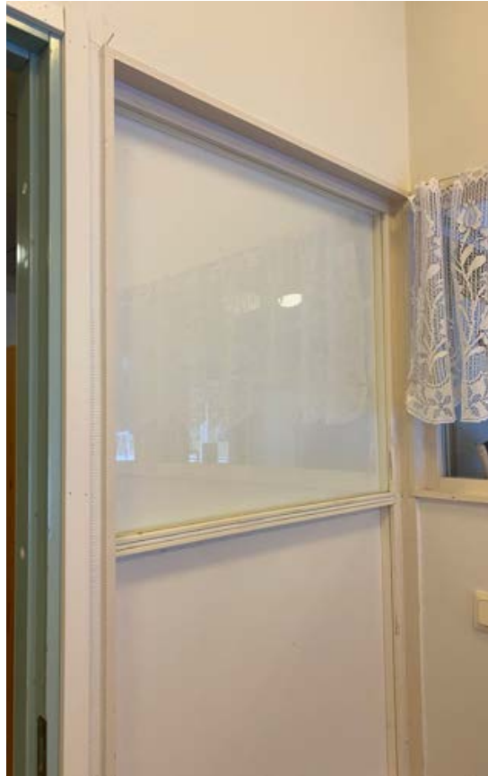
Umpeen levytetty ikkuna. Kuva: Violet Raitala 2024
