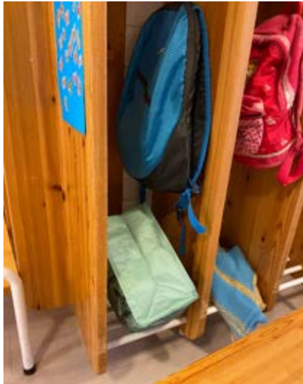
1. Lasten naulakoissa on penkkien osumista aiheutunutta kulumista. Kuva: Hilda Peltokorpi 2024.
