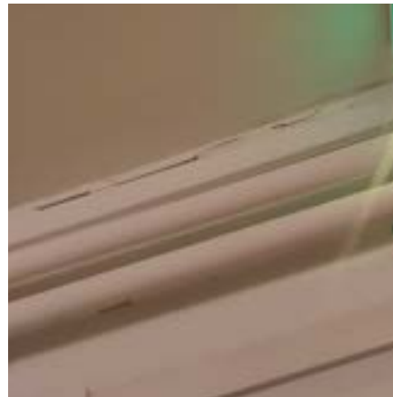
Vaurio 88. Maalipinnoissa halkeamia seinän ja alakatno rajassa. Huone 32. Kuva: Roope Mustonen 2024.
