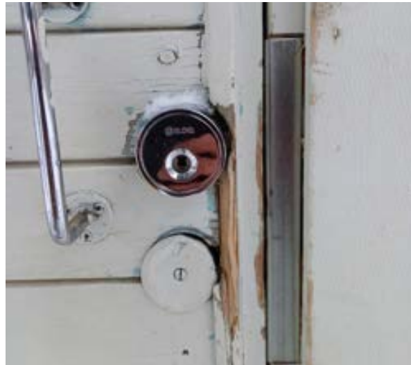
Kuva: Ryhmä 4, Kirsikka Lehtiniemi Molempien pihavarastojen ulko-ovissa oli kulumista maalipinnassa. Huoltomaalauksista ei ole tarkkaa tietoa, mutta ovien sävyt ovat vaihtuneet molemmissa varastoissa. Alkuperäinen sävy on ollut turkoosi, joka on havaittavissa nykyisen valkoisen maalipinnan alta. Kuva: Kirsikka Lehtiniemi 2024
