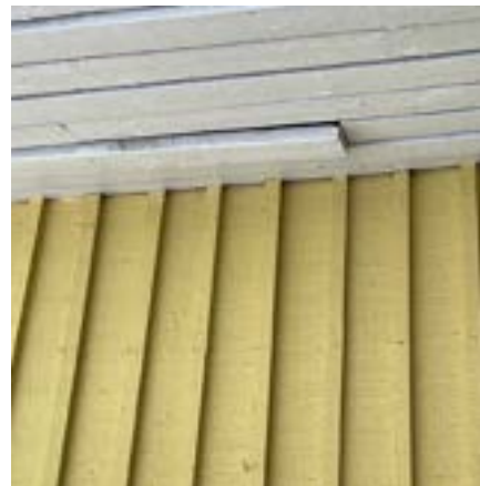
Yksittäisenä vauriona repsottava räystääslaudoitus. Katja Maaninka 2024.
