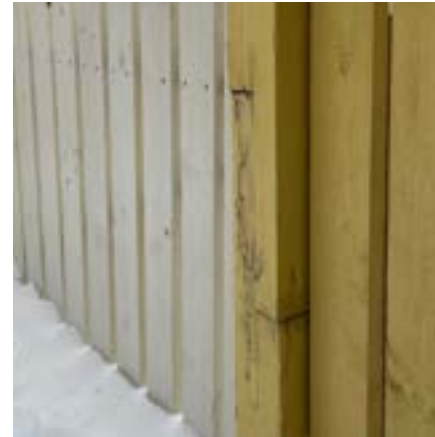
Vaurio 2. Aitojen maali rapistunut. Katja Maaninka 2024.
