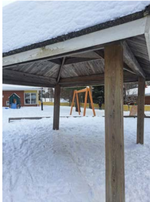
Pihassa olevassa katoksessa on pintakulumaa ja rakenteellista vauriota.
