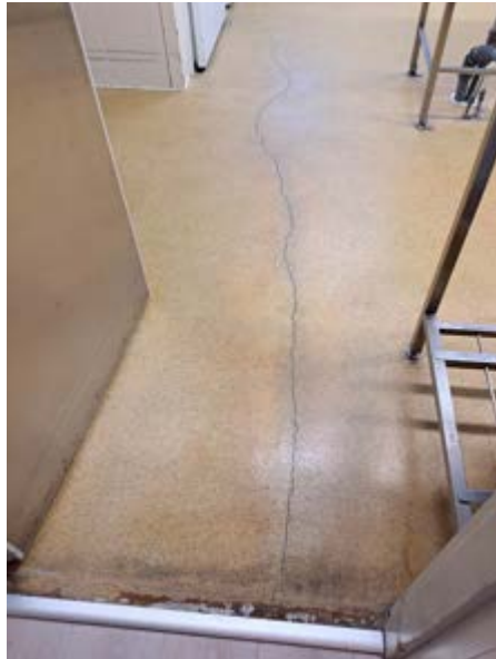
Halkeama keittiön betonilattiasa. Kuva: Jere Limnell.
