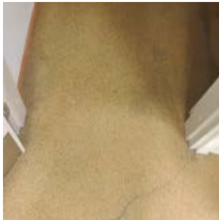
Vaurio 79. Betonilattiassa halkeamaa. Huone 33. Roope Mustonen 2024.
