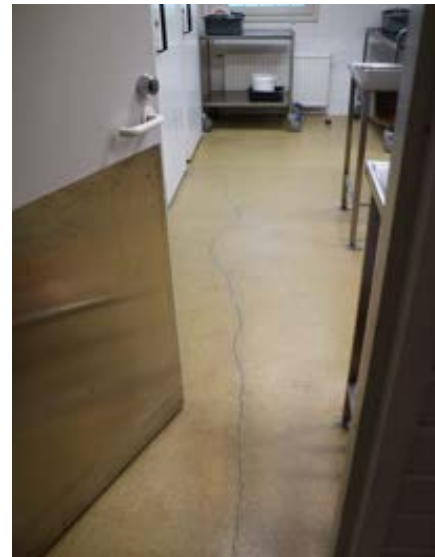
7. Akryylibetonilattiassa on halkeamia. Kuva: Kim Ramsay 2024.
