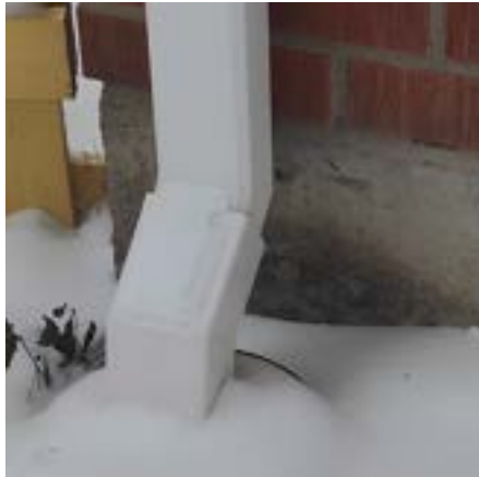
Vaurio 5. Perusmuurissa härmistymää. Roope Mustonen 2024.
