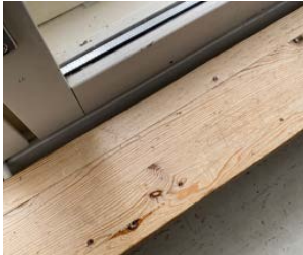
Kotikeittiön (02) ikkunalauta kulunut käytössä Kuva: Violet Raitala 2024
