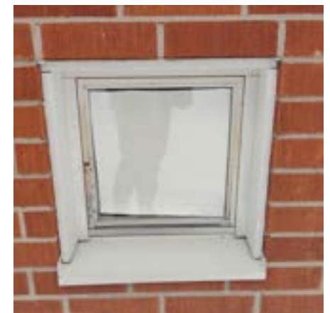
Vaurio 1. Ikkunanpuitteissa maali rapistunut. Roope Mustonen 2024.
