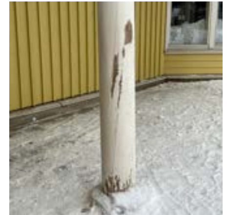
Vaurio 3. Pilareissa kolhuja ja maalit rapistuneet. Katja Maaninka 2024.
