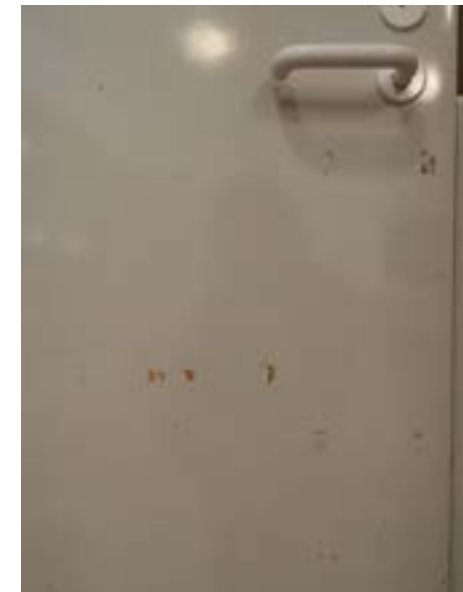
Pintavaurioita ryhmähuoneen ovesa. Kuva: Lauri Antila.
