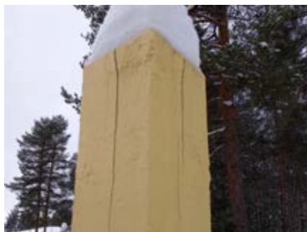
Pääportin pilarin lohkeilua. Vaurio on pilareissa melko tyypillinen. Kuva: Kirsikka Lehtiniemi 2024
