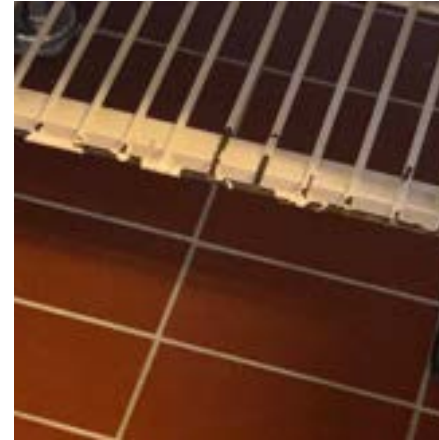
Vaurio 75. Maalit hilseilleet WC:n kiintokalusteiden hyllyiltä. Huone 30. Kuva: Salli Nokelainen 2024.
