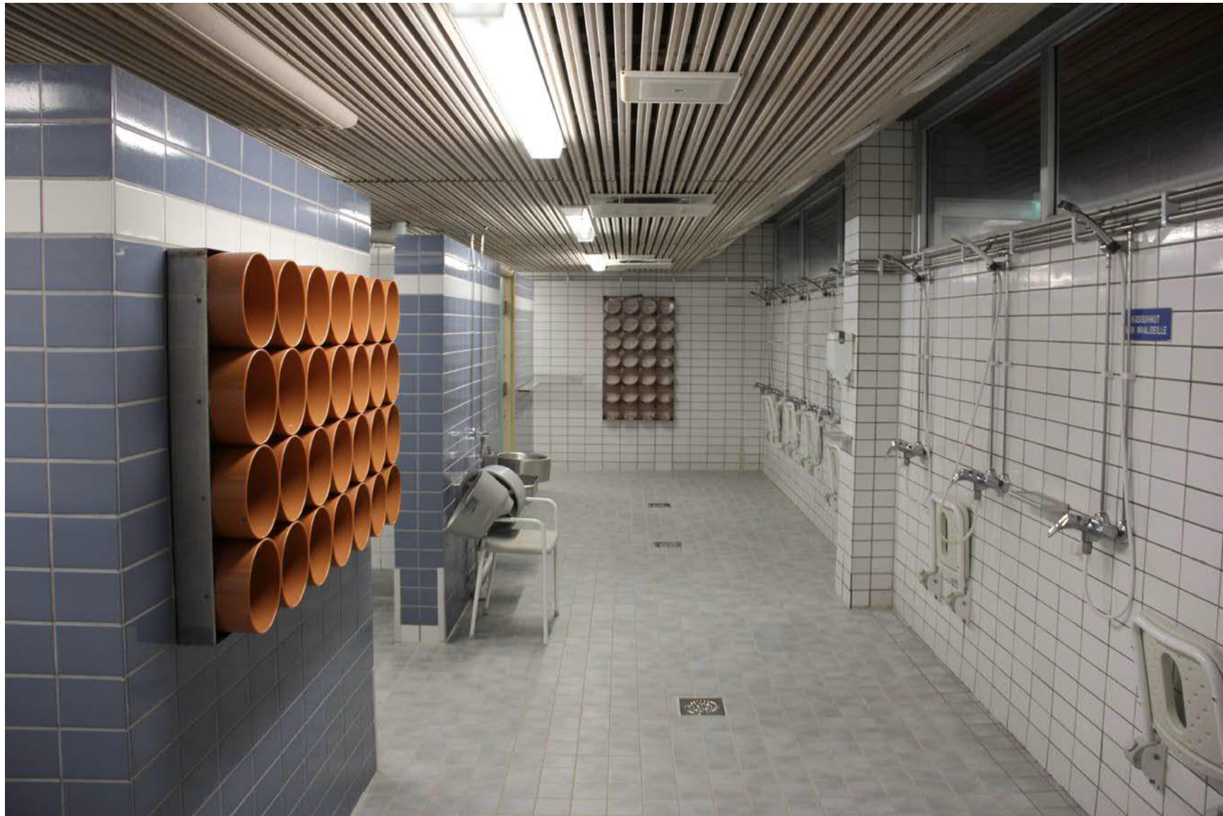
74. Miesten pesutilat nykytilassa. Ikkunat on pimennetty ja tuuletus tapahtuu koneellisesti. Alkuperäinen graafinen laitoitus on pehmentynyt ja saanut uusia sävyjä. Kiinteät penkit on purettu ja tilalle on asennettu kääntyvät klaffi-istuimet. Alakattoa on laskettu ilmastointiputkiston vuoksi ja se on päällystetty puurimoituksella. Etualalla näkyvä uimahousuteline on uimahallin verstaan omaa tuotantoa.
