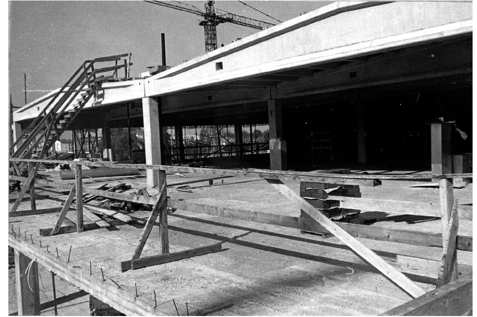
21. Jännitetyt HI-teräsbetonipalkit mahdollistivat allashuoneiden pitkät jännevälit. Kuvassa rakennustyömaa kahvilan kohdalta. KUVA: Pohjois-Pohjanmaan museon kokoelmat
