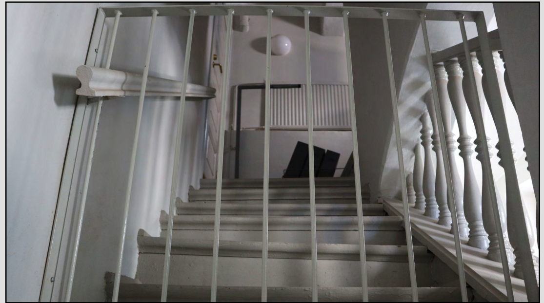
Portaat on katkaistu vuoden 1950 muutoksissa. Käsijohteessa on rataiskoprofilointi ja holviväliin on asennettu sorvatut kaiteet.
