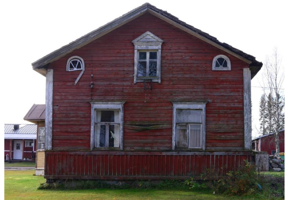
Ala-Kaakisen asuinrakennuksen T-karmi-ikkunat ja niitä kehystävät klassistiset vuorilaudat sekä ullakkokerroksen päätykolmiokoriste ja lunetti-ikkunat edustavat 1800-luvun talonpoikaista klassismia.
